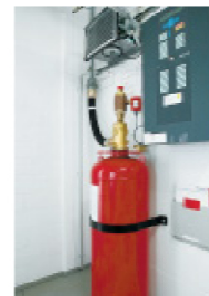
Modernes Löschsystem: Bei Feuer bekämpft das Gas in diesem Behälter den Brand – Menschen im Serverraum ersticken nicht daran. Mehrere Tausend Euro kostet eine Füllung.
