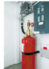
Modernes Löschsystem: Bei Feuer bekämpft das Gas in diesem Behälter den Brand – Menschen im Serverraum ersticken nicht daran. Mehrere Tausend Euro kostet eine Füllung.
