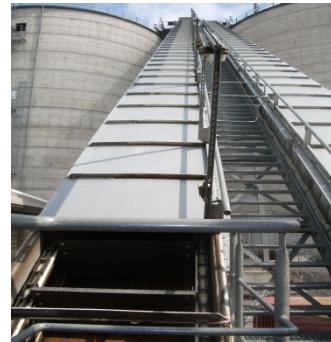
Biomassekraftwerk Förderkettenband mit Mitnehmern aus obo-Festholz®
